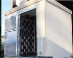
24 kV Stationsprüfungen mit Scheidt, Borner und Betonbau
